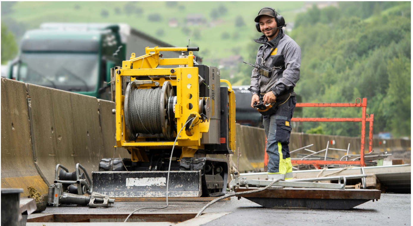
Im Rahmen der Bauarbeiten für den 2,1 Kilometer langen neuen A8 Tunnel Kaiserstuhl verlegten die Mitarbeitenden des Bereichs Netzbau während verschiedener Bauphasen Leitungen. Im Mai 2023 zog Netzelektriker Raphael Pfister zusammen mit seinen Kollegen im Gebiet Kaiserstuhl mit der Zugwinde neue 16 kV-Leitungen in bestehende Rohranlagen ein und installierte neue Anschlüsse.
