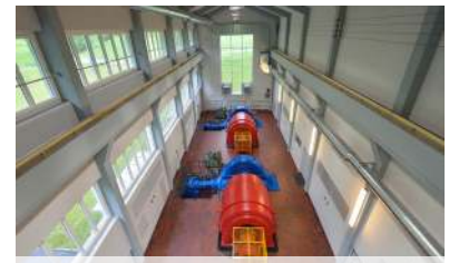
Maschinenraum Kraftwerk Hugschwendi
