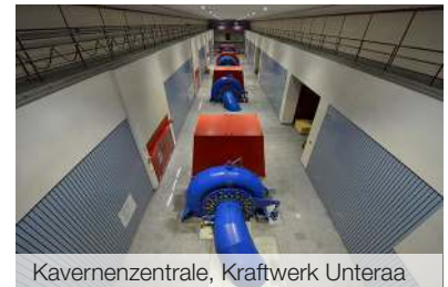
Kavernenzentrale, Kraftwerk Unteraa
